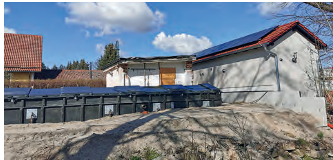
neue Anlage mit altem und neuem Pumpenhäuschen
